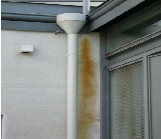
Kuva 1. Tukkeutuneen sadevesirännin aiheuttamia valumajälkiä julkisivulla, ylimääräiset valumat julkisivupinnalla nostavat rappauspintaan kohdistuvaa säärasitusta
