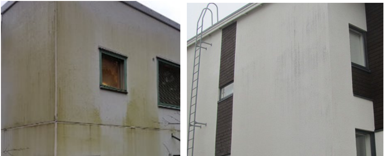
Kuva 2. Esimerkkejä leväkasvustosta julkisivupinnalla, jota voidaan poistaa yllä mainitulla menetelmällä
