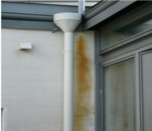
Kuva 1. Tukkeutuneen sadevesirännin aiheuttamia valumajälkiä julkisivulla, ylimääräiset valumat julkisivupinnalla nostavat rappauspintaan kohdistuvaa säärasitusta
